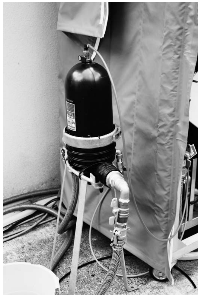
追加交換を実施した大型のストレーナー
