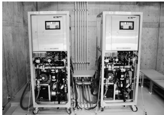
通常は2台を自動で並列運転し、非常時には1台を被災現場等に搬入する
