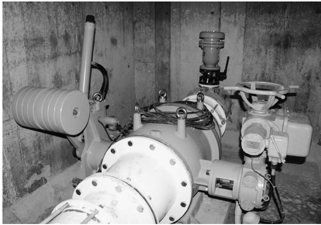
城山配水池に整備されたブロンジャー形（口径400mm）
