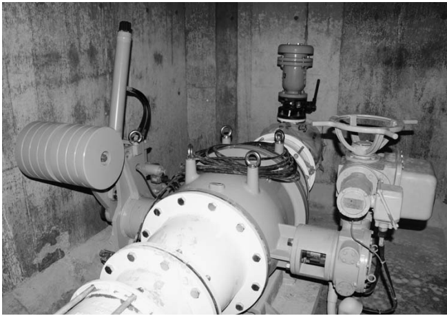
城山配水池に整備されたプランジャー形（口径400mm）
