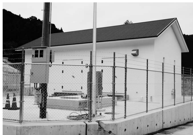
3月末に工事完了予定の栗栖川簡易水道（伏菟野地区）施設
