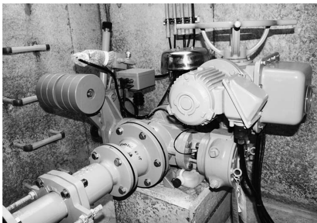
真山配水池に整備された機械直動形（口径150mm）
