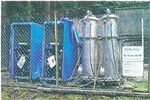
乙河内浄水場で活躍したアクアレスキュー
