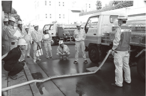
浄水場内の応急給水装置から給水車へ充水
