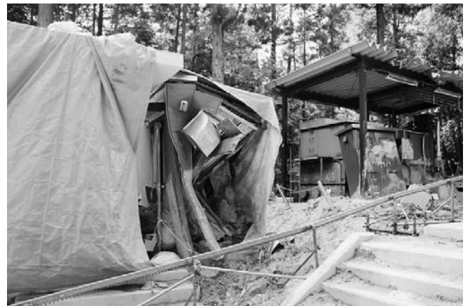
被害を受けた観音寺水源地の浄水施設
