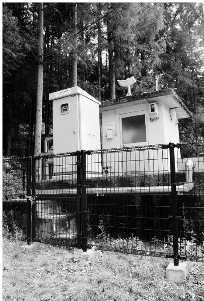
配水地上部に設置されたアクアMF-R
