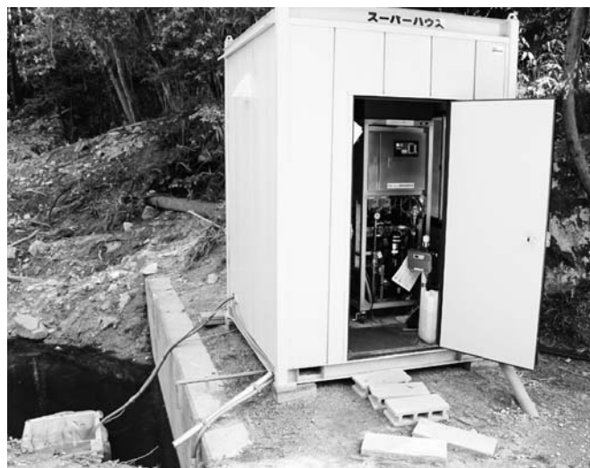
現在の取水・浄水設備。右の建屋内に清水合金製作所製のアクアレスキュー、活性炭注入設備、マンガン除去装置など入っている
