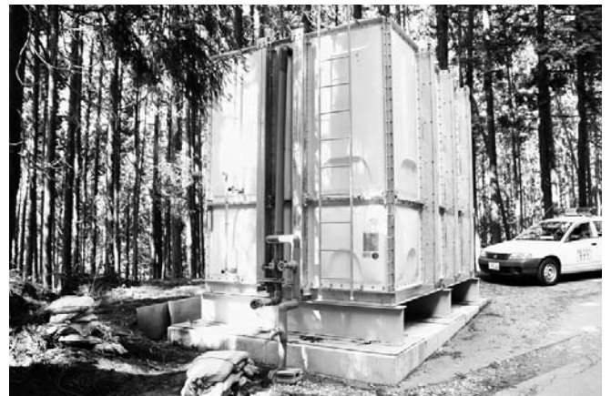
林道脇の仮設受水槽
