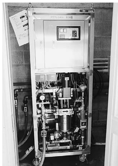
設置しているアクアレスキュー
