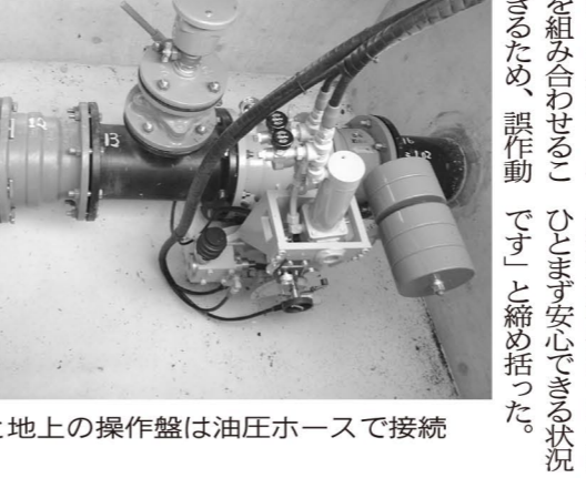
弁本体と地上の操作盤は油圧ホースで接続される
