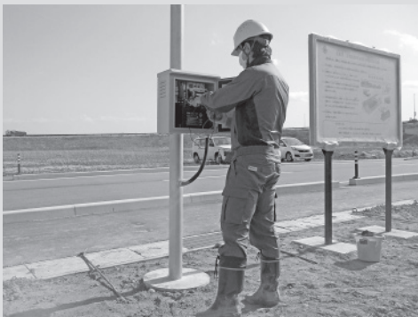
弁の作動状況を 地上で確認できる
