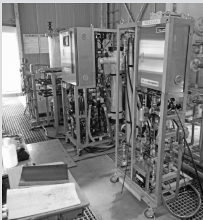
湖沼水原水に安定処理(右=RO膜ユニット)
