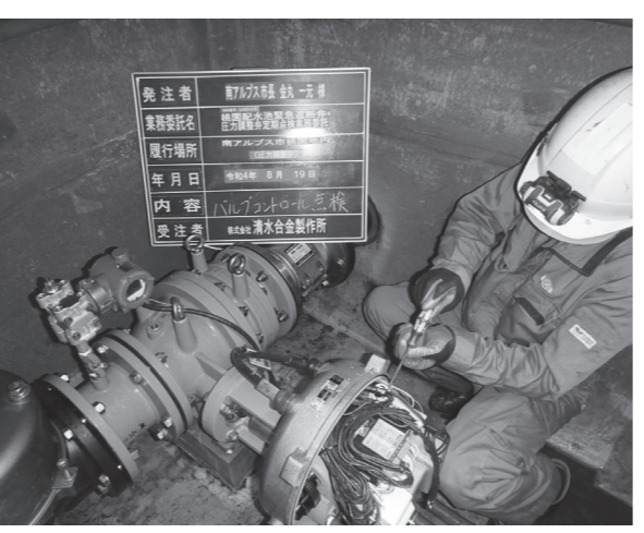
プランジャーバルブの配線部をチェック
